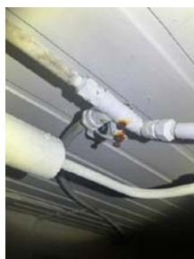
Jording på rør har rustet tilkobling.
