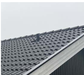
Takhatt vurdert til avløpslufting.
