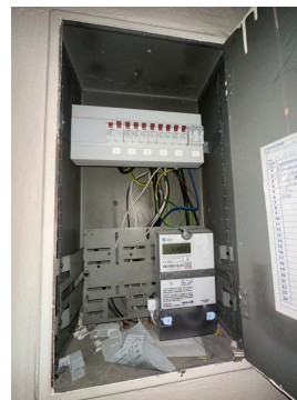
Sikringsskap med automatsikringer.
