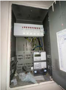
Sikringsskap med automatsikringer.
