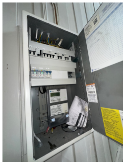
Sikringskap med automatsikringer.
