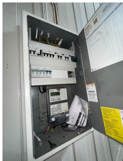
Sikringskap med automatsikringer.
