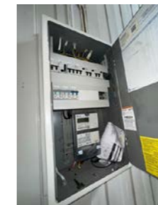
Sikringsskap med automatsikringer.
