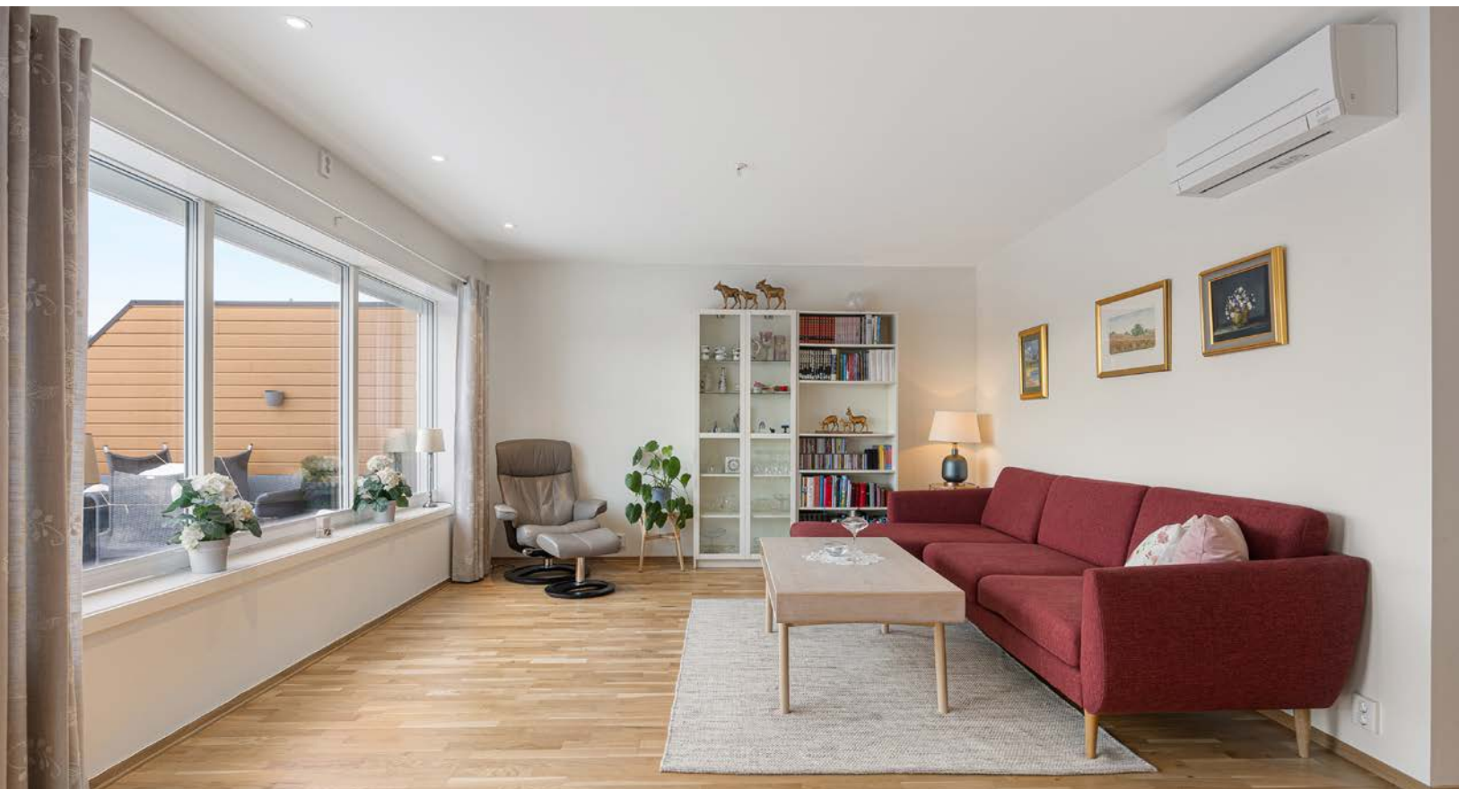
En varmepumpe av typen luft-til-luft sørger for en jevn innetemperatur året rundt.
