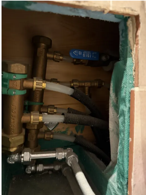
Samletokker for rør-i-rør og hovedstoppekran er plassert i sjakt på bad.
