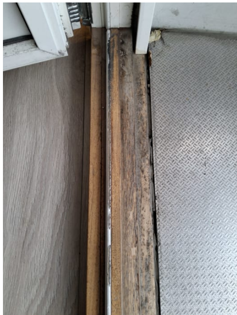
Pakning i karm til terrassedør er revnet.
