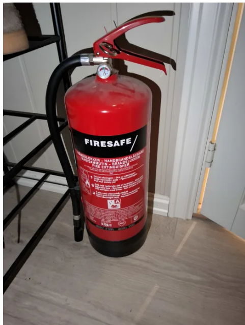
Brannslukningsapparat er plassert i entré.
