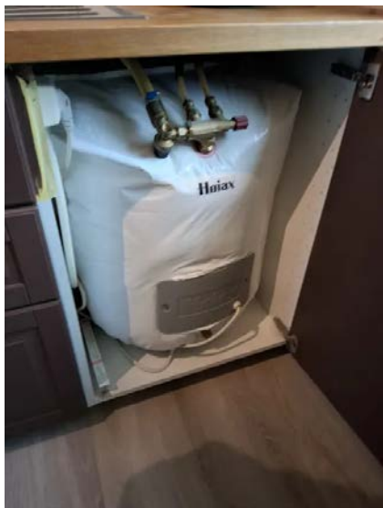
Varmtvannsbereder er plassert i kjøkkenskap.
