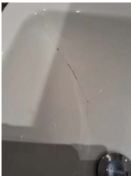
Oppsprekt porselen i servant.
