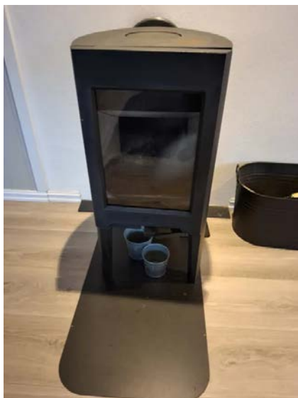
Vedovn med glassdør i stue.
