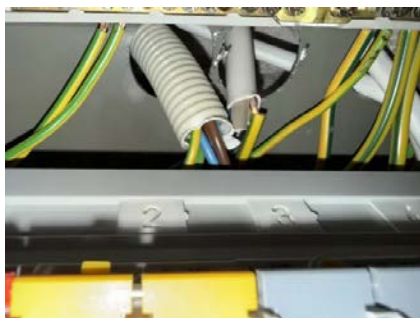
Det registreres utettheter rundt kabelføringer i sikringsskapet.
