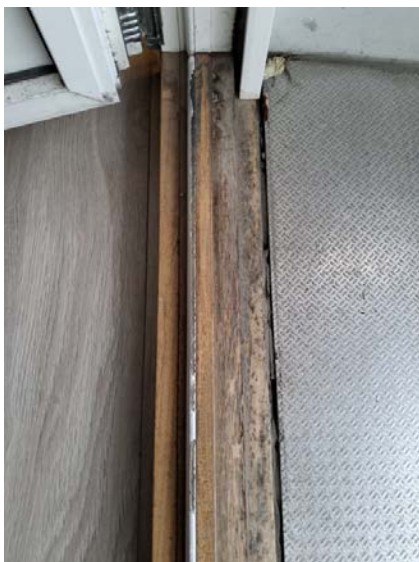
Pakning i karm til terrassedør er revnet.
