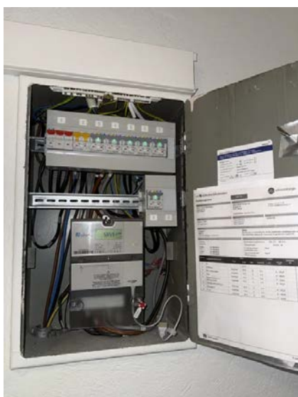
Sikringsskap med automatsikringer er plassert i felles trappegang.
