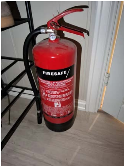
Brannslukningsapparat er plassert i entré.
