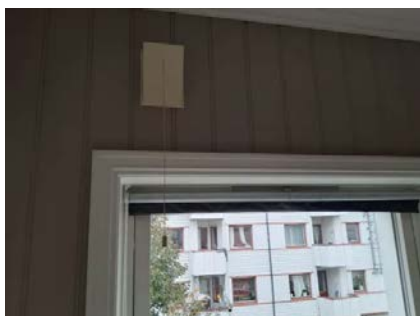
Leiligheten har naturlig ventilasjon med klaffventiler på vegg og spalteventiler i vinduer.
