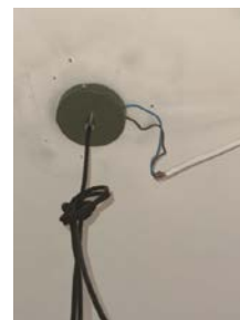
Ufagmessig tilkobling av taklampe
