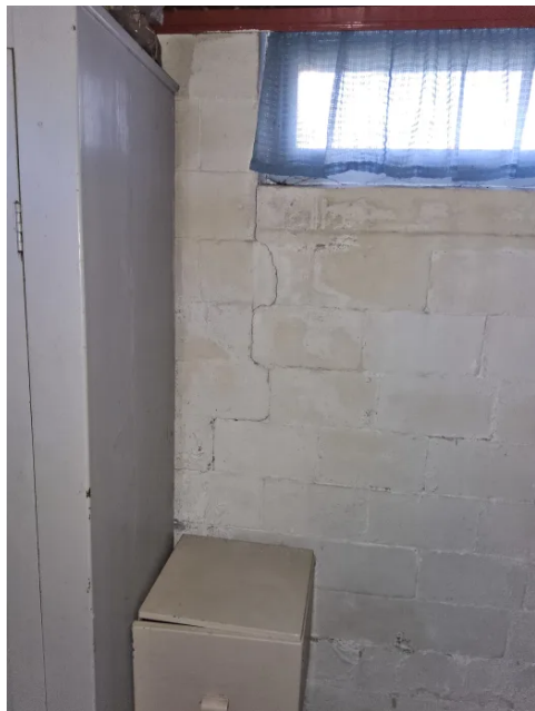
Bilde viser sprekk i grunnmur.
