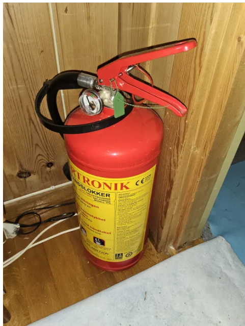
Bilde viser brannslukningsapparat.
