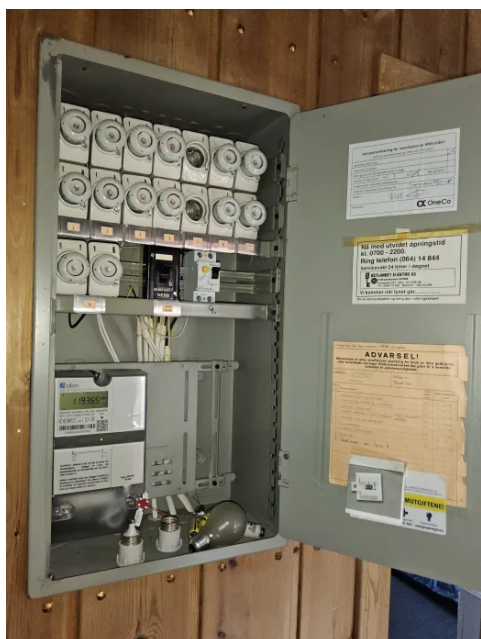
Bilde viser sikringsskap.
