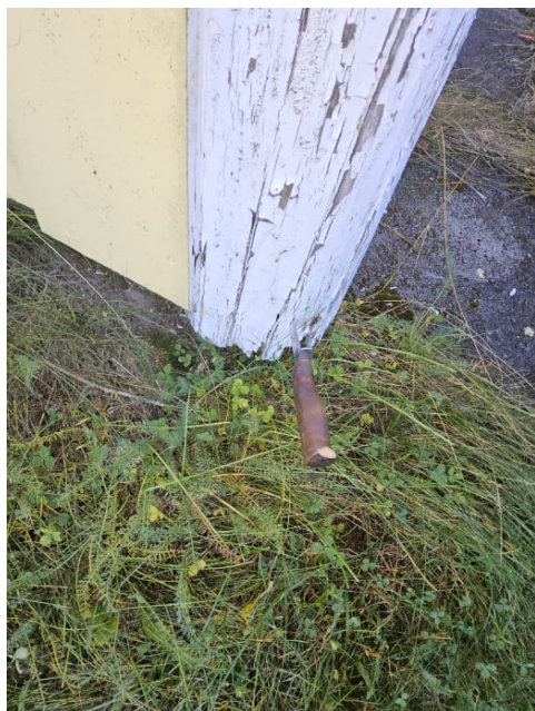
Bilde viser råteskade.
