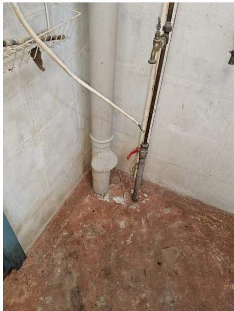
Bilde viser stakeluke plassert i kjeller.
