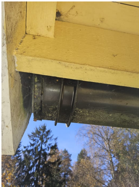
Bilde viser takrenne med symptomer på lekkasje.
