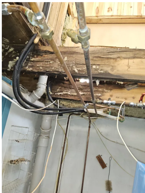
Bilde viser råteskader i etasjeskiller.
