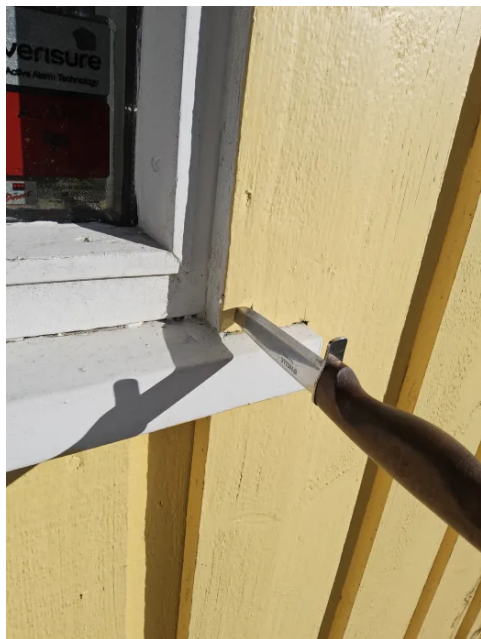
Bilde viser råteskade i omramming.
