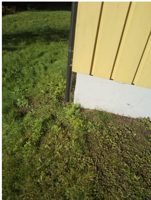
Bilde viser taknedløp avsluttet over bakken.
