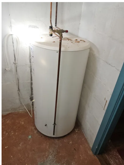
Bilde viser varmtvannsbereder.
