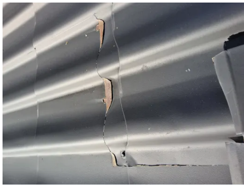
Bilde viser rust på takplate.
