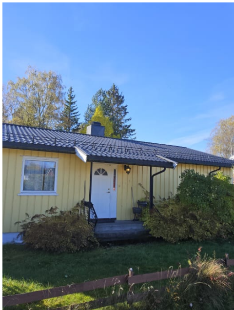
Bilde viser snøfangere.
