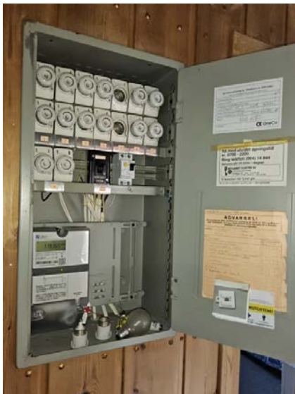
Bilde viser sikringsskap.
