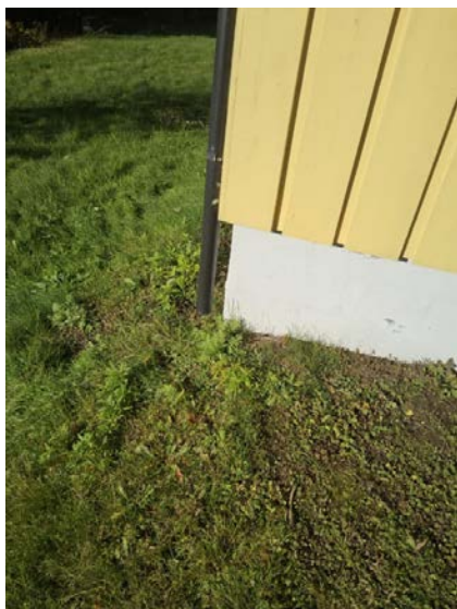
Bilde viser taknedløp avsluttet over bakken.
