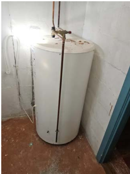
Bilde viser varmtvannsbereder.
