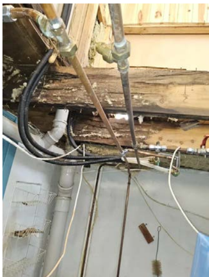
Bilde viser råteskader i etasjeskiller.
