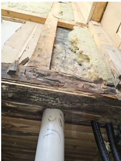
Bilde viser fukt og råteskadede konstruksjoner mot toalettrom.
