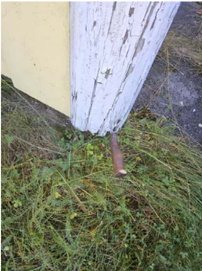
Bilde viser råteskade.
