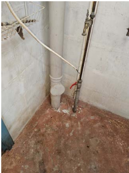
Bilde viser stakeluke plassert i kjeller.
