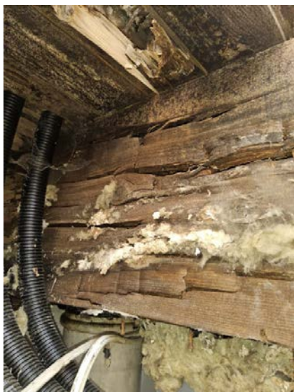
Bilde viser råteskadet etasjeskiller i tilknytning til badet.
