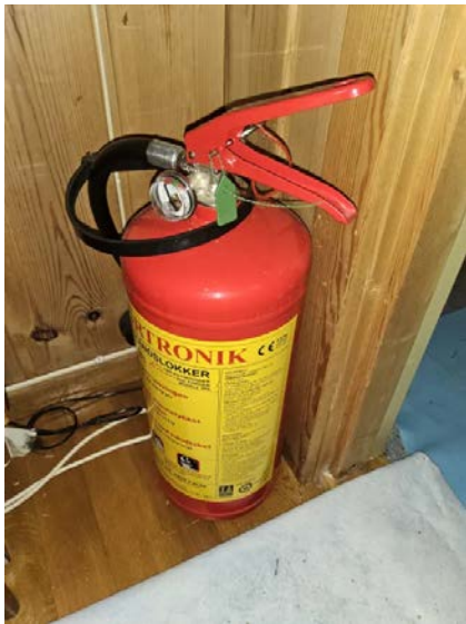
Bilde viser brannslukningsapparat.
