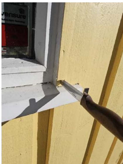
Bilde viser råteskade i omramming.
