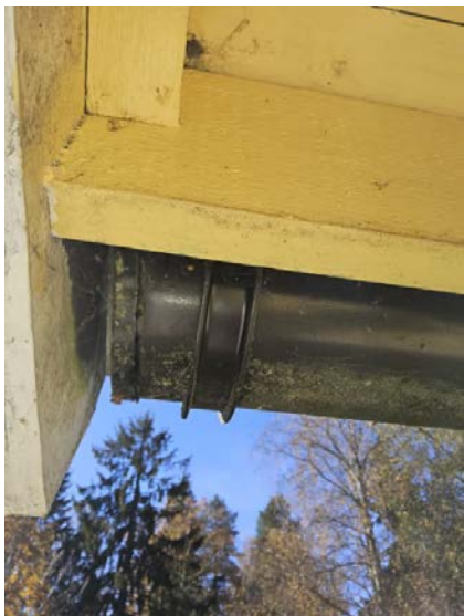
Bilde viser takrenne med symptomer på lekkasje.
