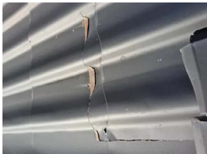
Bilde viser rust på takplate.
