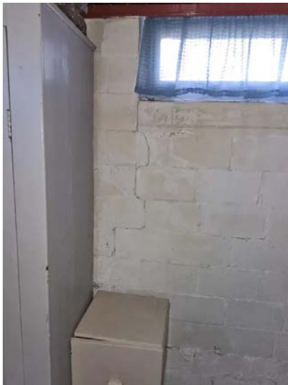
Bilde viser sprekk i grunnmur.
