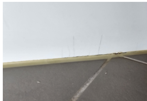
Krakelering/overflateriss samt årlig vedheft på våtromssilikon.
