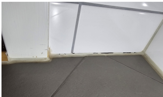
Dårlig vedheft på våtromssilikon i overgang gulv/vegg.
