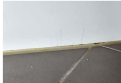
Krakelering/overflateriss samt årlig vedheft på våtromssilikon.
