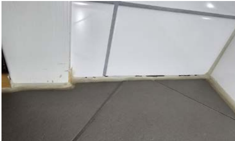
Dårlig vedheft på våtromssilikon i overgang gulv/vegg.
