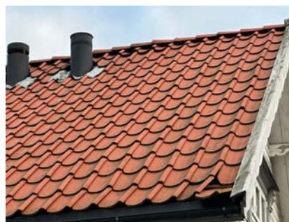
Ujevnheter i takflatene som normalt i bygninger med denne alder og konstruksjon.
