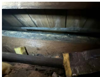
Spor etter treskadeinsekter i takkonstruksjonen.
