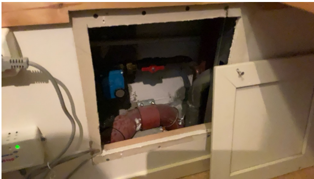
Stoppekran i bod ved kjøkken
