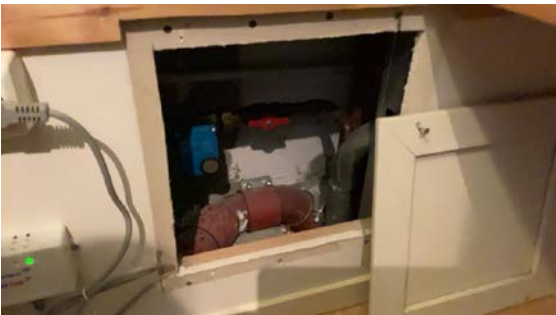
Stoppekran i bod ved kjøkken
