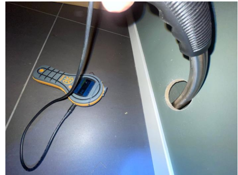
Fuktmåling under trapp
