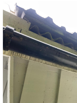
Synlig bølgeeternitt under takteking.
