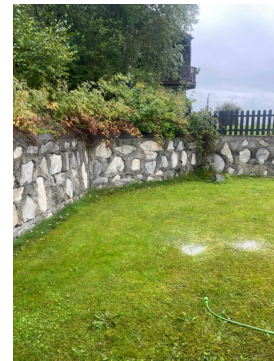
Sprekker i mur mot terreng på øst
