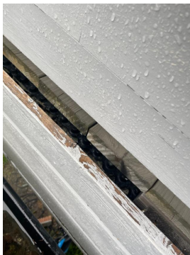
Synlig knotteplast og oppsprukket maling.
