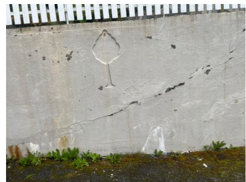
Sprekker i mur ved parkering på sørside.
