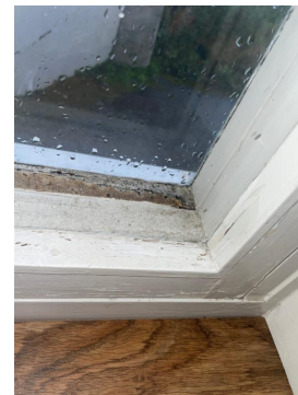
Synlige tegn til muggsopp/fukt.
