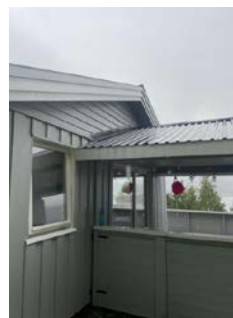
Ufaglig beslagsløsning ved vegg/tak
