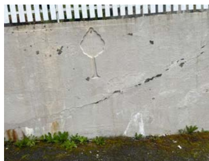
Sprekker i mur ved parkering på sørside.
