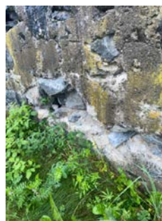
Sprekker og skader i mur langs med veg/ned mot garasje
