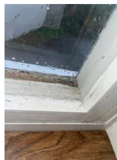
Synlige tegn til muggsopp/fukt.
