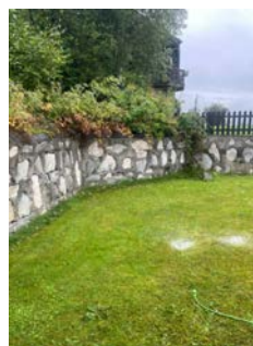
Sprekker i mur mot terreng på øst
