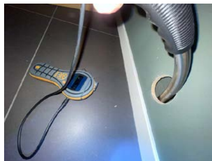
Fuktmåling under trapp
