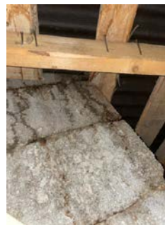
Synlig vannlekkasje ved pipegjennomføring.
