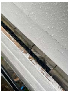
Synlig knotteplast og oppsprukket maling.
