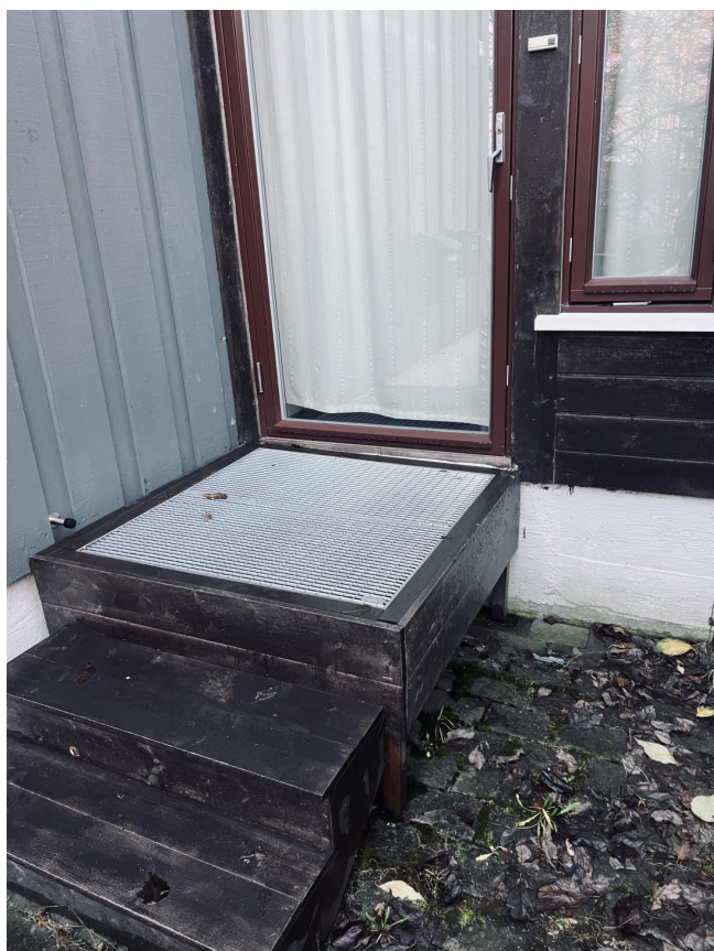
Trapp til utleiedel mangler fallsikring/rekkverk.
