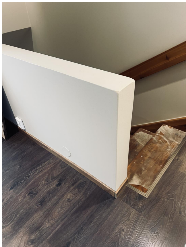
Rekkverksløsning i 2. etg. Den er kun 77 cm. høy. (Bilde er tatt før teppe ble lagt.)
