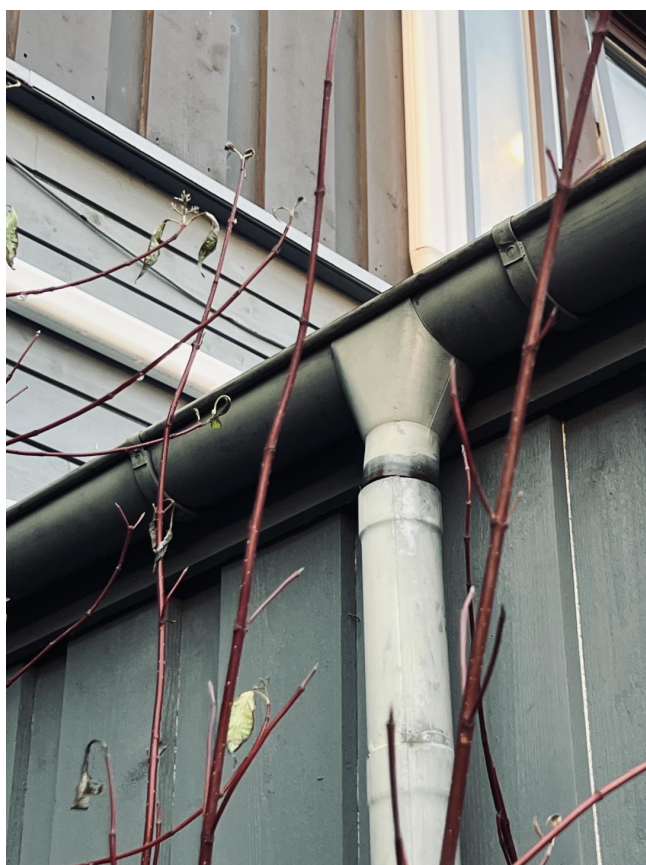
Nedløp har "glidd" i fra takrenne.
