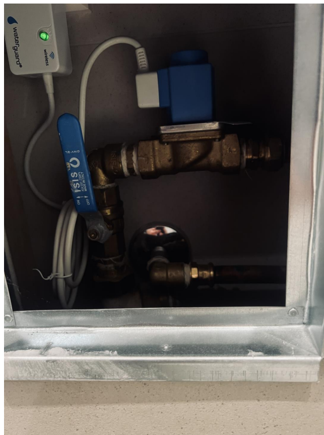
Stoppekran bak luke i kjeller.
