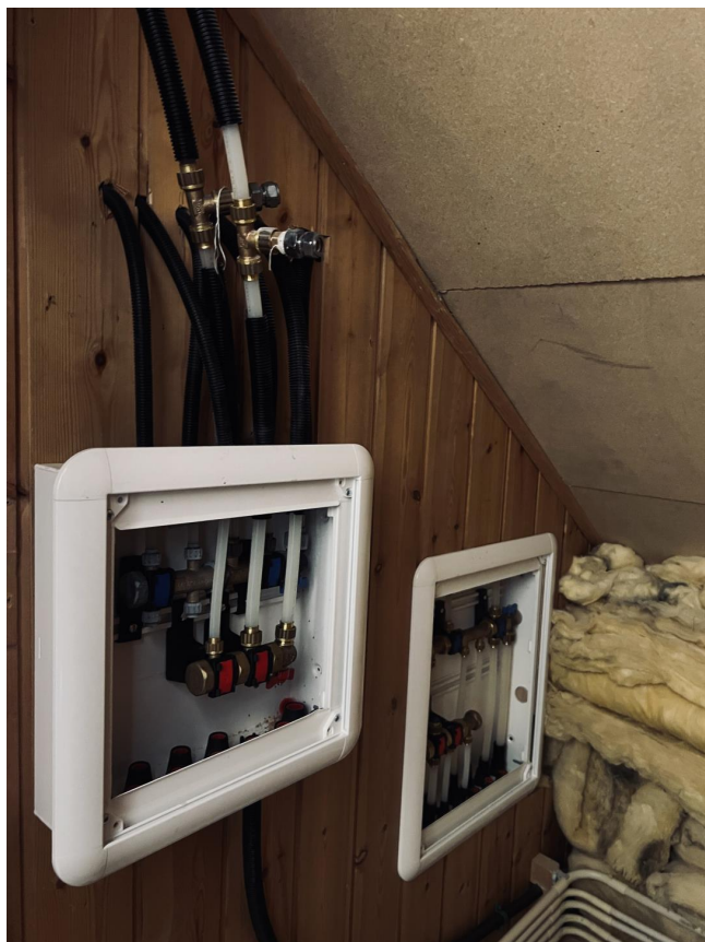
Fordelerskap. To koblinger er plassert utenfor fordelerskap.
