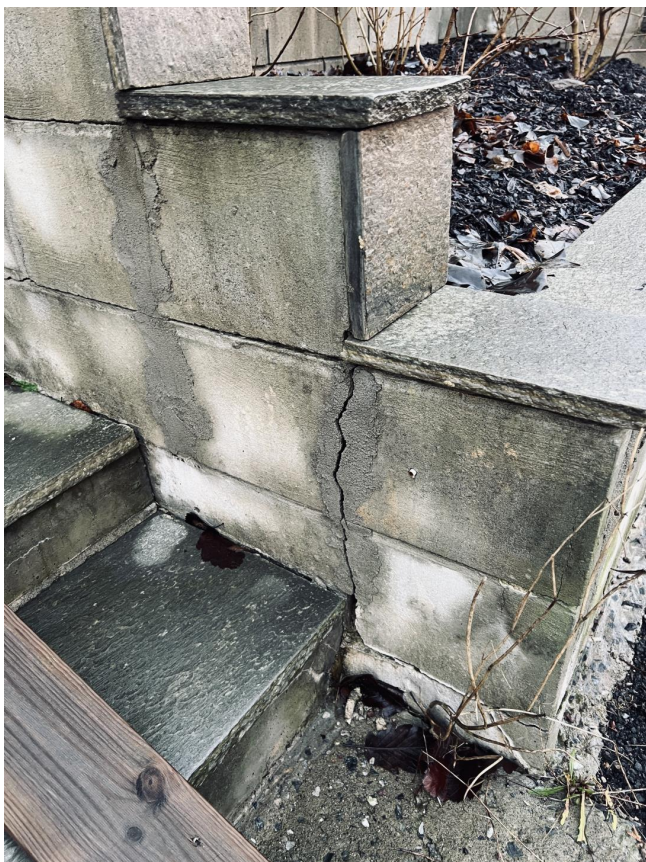
Riss/sprekk i forstøttningsmur.
