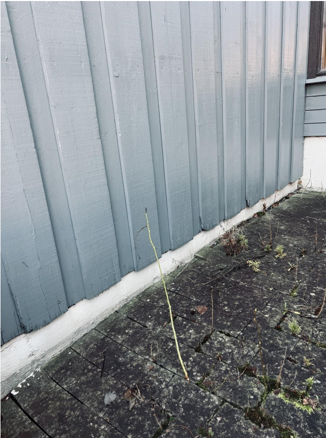
Utvendig råteskade på panel på inngangsparti.
