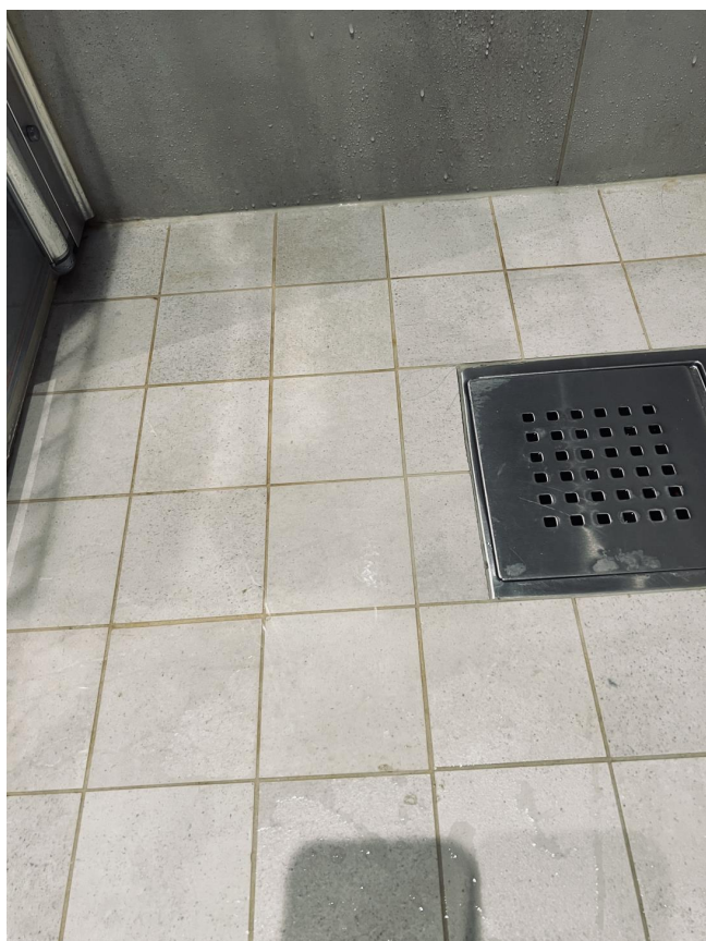
Lite fall i del av nedsenket dusjsone.
