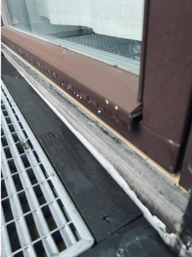
Manglende beslag under inngangsdør til utleiedel.
