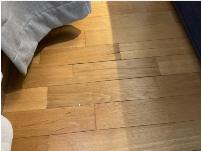
Slitasje/skade i parkett i stue i 1. etg.
