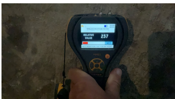
Høye fuktverdier i vegger registrert
