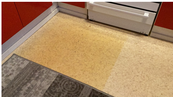
Misfarging på gulv.
