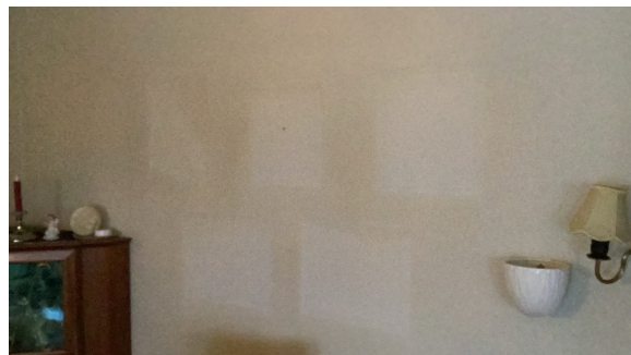
Misfarging på vegg.
