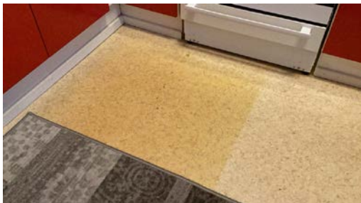
Misfarging på gulv.
