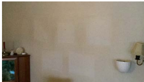
Misfarging på vegg.
