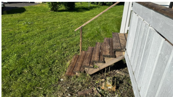
Trappen mangler rekkverk.
