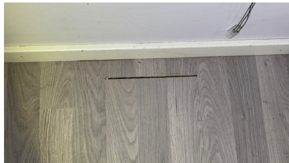
Det er registrert glipper i laminatskjøter.
