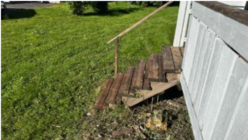
Trappen mangler rekkverk.
