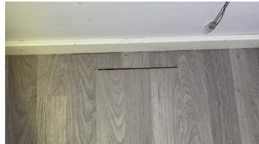
Det er registrert glipper i laminatskjøter.
