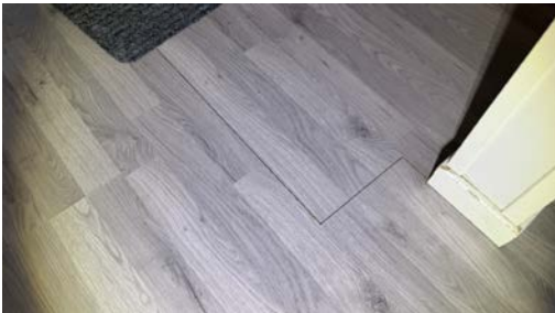
Det er registrert glipper i laminatskjøter.
