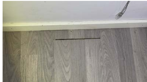
Det er registrert glipper i laminatskjøter.
