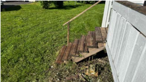
Trappen mangler rekkverk.
