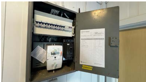
Kontroll av el-skap og kursfortegnelse.
