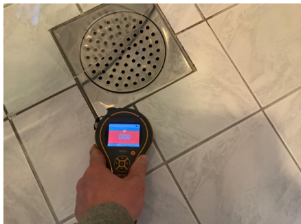
Økende fuktnivå mot sluken.
