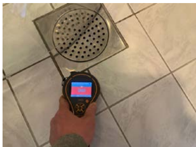
Økende fuktnivå mot sluken.
