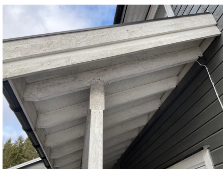
Svertesopp i takkonstruksjon over terrasse.
