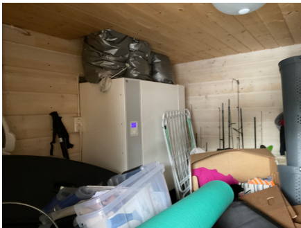
Ventilasjonsanlegg i bod.
