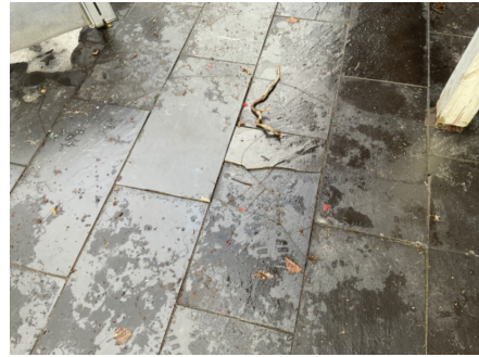
Løse og sprukne fliser.
