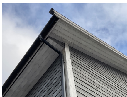
Svertesopp på takutstikk bolig
