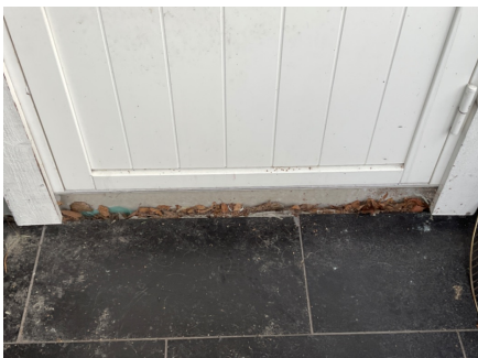
Manglende beslag under terrassedør.
