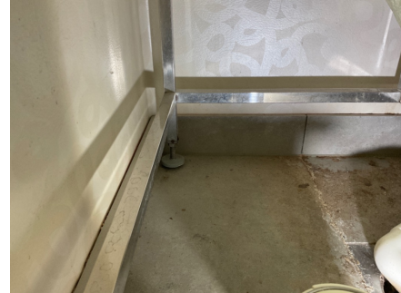
Manglende fuger i overkant av oppkantflis.
