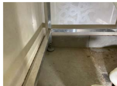
Manglende fuger i overkant av oppkantflis.
