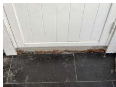
Manglende beslag under terrassedør.
