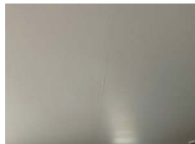
Sprekker/riss i tak i stue.
