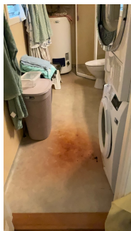
Merker/skader i gulvbelegg på badet.
