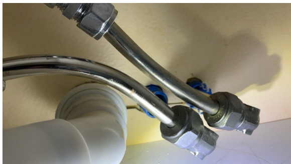
Utettheter i membran rundt rørgjennomføringer.
