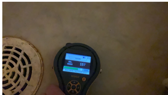
Ved enkle fuktsøk og bruk av fuktindikator registrerte jeg verdier utover hva som forventes som normalt på utsatte steder. Dusjing direkte på gulv/vegger gir økt belastning på konstruksjonene.
