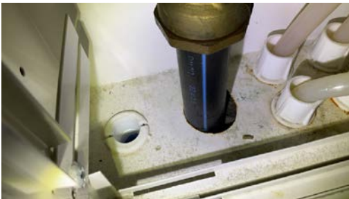
Det er ikke tett tilslutning rundt vanninntak / vannrør i fordelerskap. En eventuell lekkasje kan medføre større skader i konstruksjonene.
