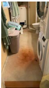
Merker/skader i gulvbelegg på badet.
