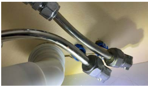
Utettheter i membran rundt rørgjennomføringer.
