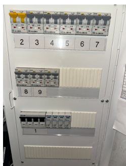
Sikringsskap med automatsikringer.
