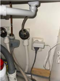
Røropplegg i kjøkkenbenk med Waterguard
