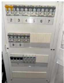
Sikringsskap med automatsikringer.
