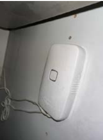
Waterguard plassert i benkeskap
