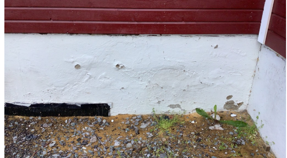
Løsnet maling og saltutslag.
