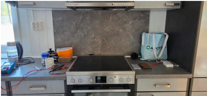
Bilde 1 Det er ikke montert komfyrvakt.
