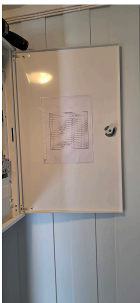
Bilde 3 Tavlen mangler merking 230V og instruks for overspenning og jordfeilautomater
