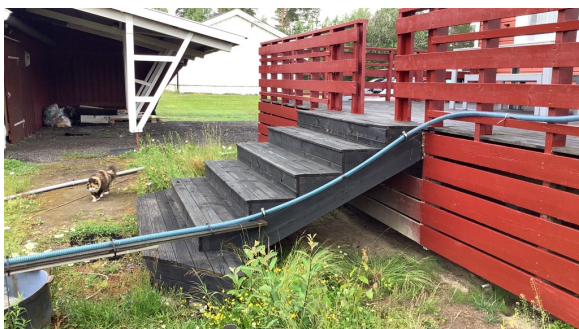
Trapp mangler rekkverk.
