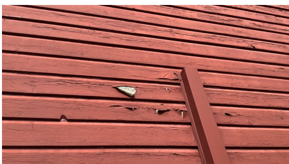
Eksempel på værslitt kledning.
