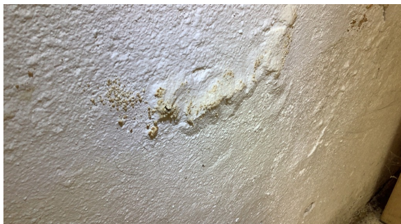
Eksempel på saltutslag på grunnmur.
