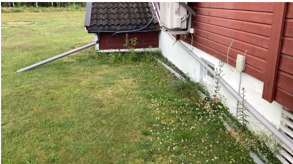
Utløpsledning fra bolig.
