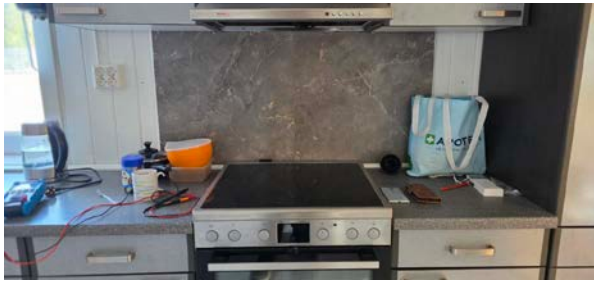
Bilde 1 Det er ikke montert komfyrvakt.
