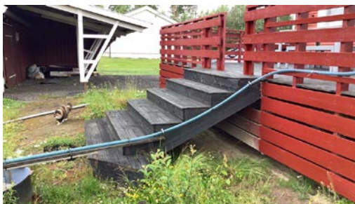
Trapp mangler rekkverk.
