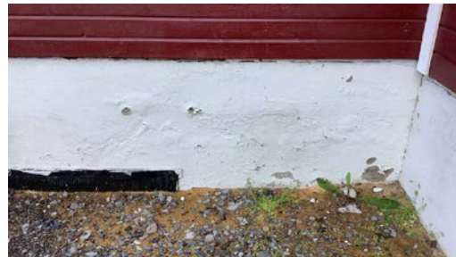
Løsnet maling og saltutslag.
