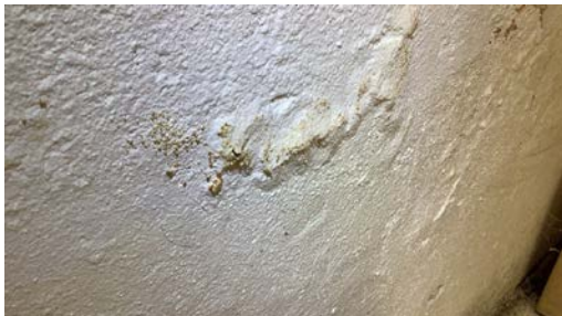
Eksempel på saltutslag på grunnmur.
