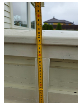
Dagens krav til rekkverk er 1 meter. Tidligere krav var 90cm.
