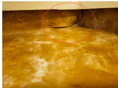
Sprekke/hull i tettesjikt/vinylbelegg
