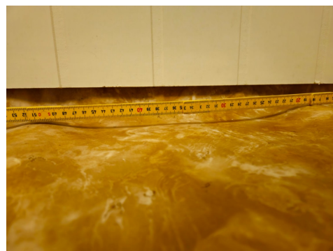
Vinylbelegg ligger løst og har deformasjoner
