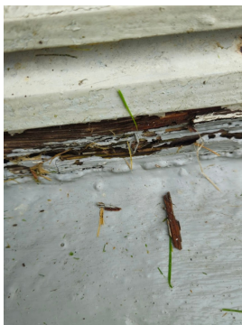
Det er påvist vinduer med fukt/råteskader.
