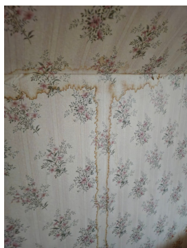
Fuktmerker fra tidligere lekkasje i tak.
