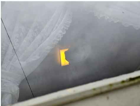
Det er påvist noen glassruter som er punktert.
