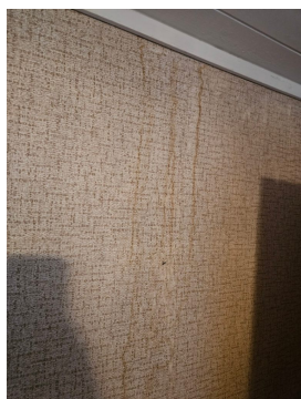
Fuktmerker fra tidligere lekkasje
