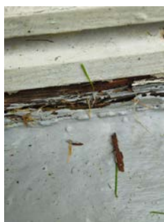
Det er påvist vinduer med fukt/råteskader.
