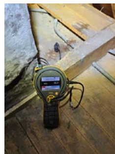
Det er påvist fuktmerker og fukt ved gjennomføring av pipe.
