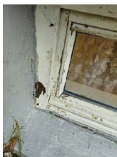
Karmene og vinduer er slitte og det er sprekker i trevirket.
