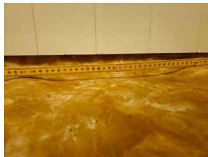
Vinylbelegg ligger løst og har deformasjoner
