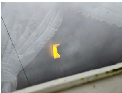
Det er påvist noen glassruter som er punktert.
