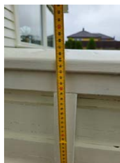
Dagens krav til rekkverk er 1 meter. Tidligere krav var 90cm.
