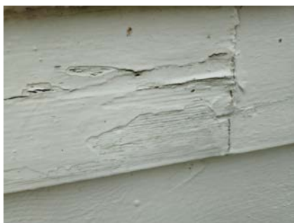
Det er værslitt/oppsprukket trevirke/trepaneler.
