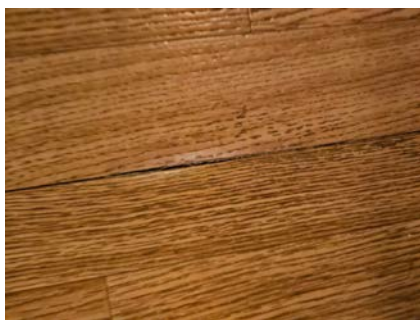
Sprekker i beleg
