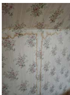
Fuktmerker fra tidligere lekkasje i tak.
