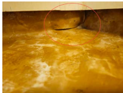
Sprekke/hull i tettesjikt/vinylbelegg
