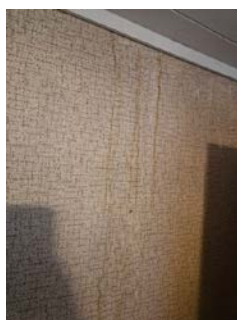
Fuktmerker fra tidligere lekkasje
