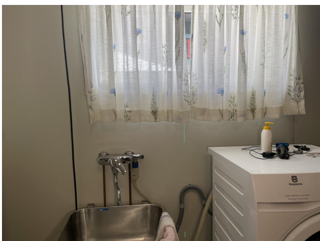
Våtsone vegg er ikke etablert.
