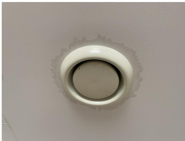
Fuktskjolder ved avtrekk tak.
