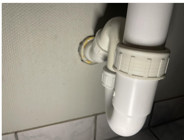
Gjennomføringer i våtsone vegg er ikke korrekt utført.
