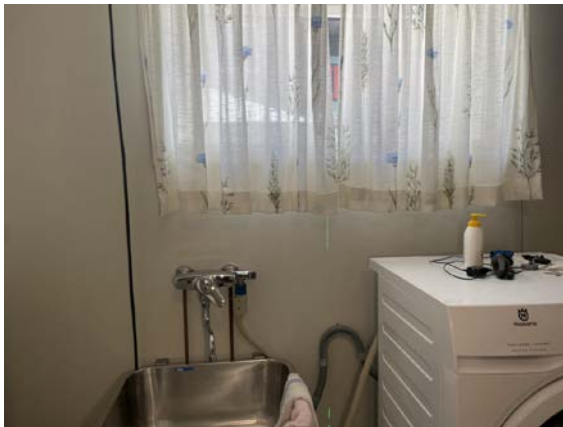
Våtsone vegg er ikke etablert.
