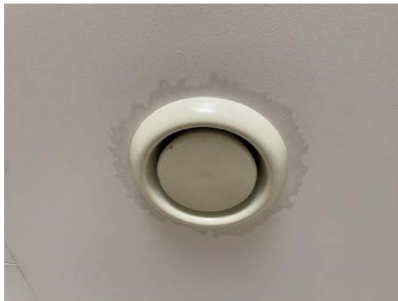
Fuktskjolder ved avtrekk tak.
