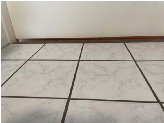
Det er ikke tilfredsstillende sikring av lekkasjevann ved dør.
