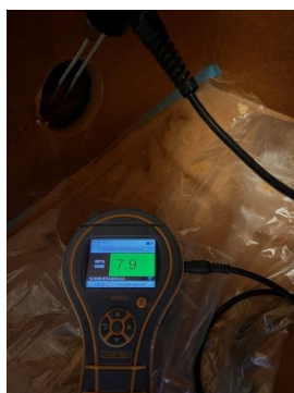
Fuktmåling i vegg mot våtsone.
