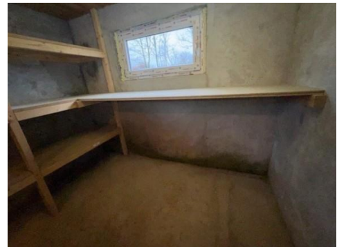
Fuktgjennomgang i grunnmur.
