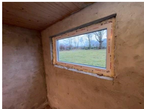
Vinduer i kjeller mangler belistning innvendig.
