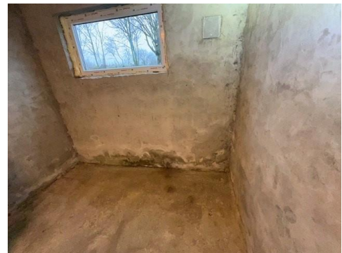
Fuktgjennomgang i grunnmur.
