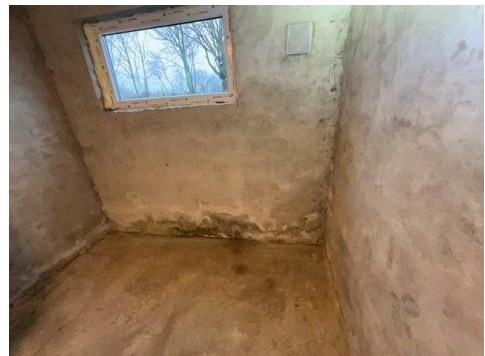
Synlig fukt vandring i grunnmur.
