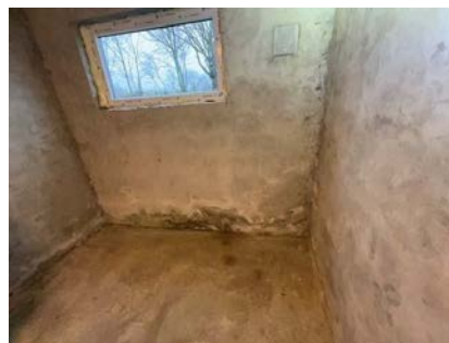
Fuktgjennomgang i grunnmur.
