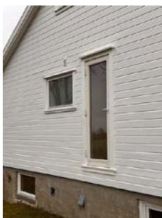
Trapp mangler utvendig foran balkongdør.
