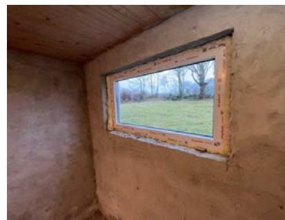
Vinduer i kjeller mangler belistning innvendig.
