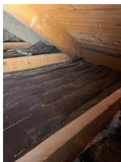
Lite lufting i loft i overgang vegg/tak
