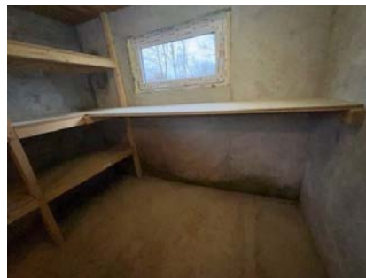
Fuktgjennomgang i grunnmur.
