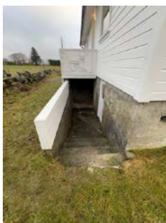
Håndløper mangler på begge sider i trappeløp.
