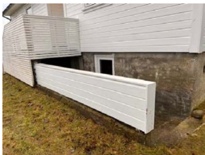
Rekkeverk er for lavt på murvange.
