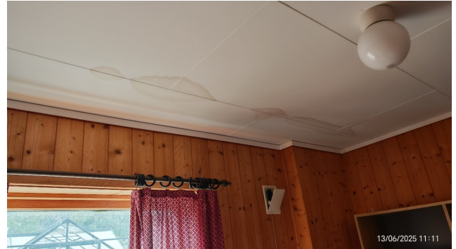
Bilde av fuktskjold underliggende kjøkken.
