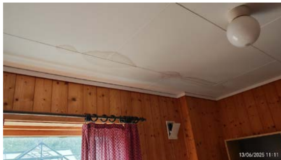
Bilde av fuktskjold underliggende kjøkken.
