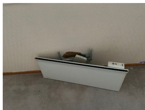
Varmeovn på soverom
