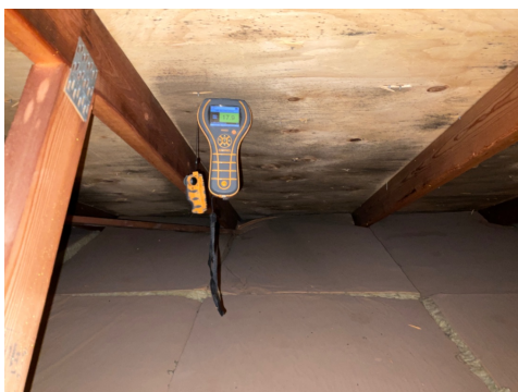
Fuktmåling 17,9 % i undertaket
