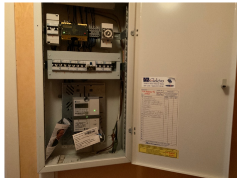
Sikringsskap i boden
