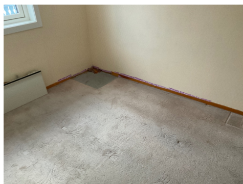
Manglende teppe på soverom og Fuging langs gulvlist
