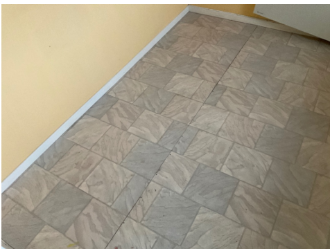
Sprekk og ufaglig utførelse på Gulvbelegg på kjøkken
