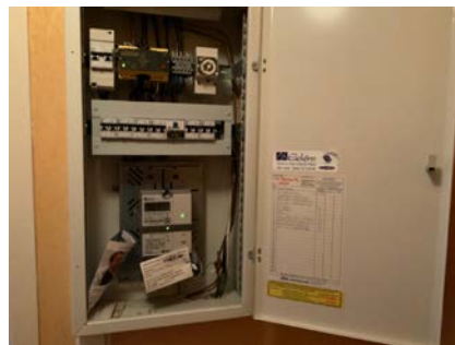
Sikringsskap i boden
