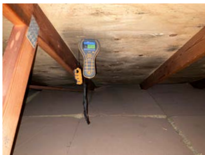
Fuktmåling 17,9 % i undertaket
