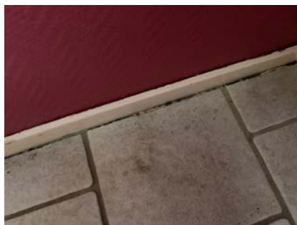
Fliser og fuger i entreen
