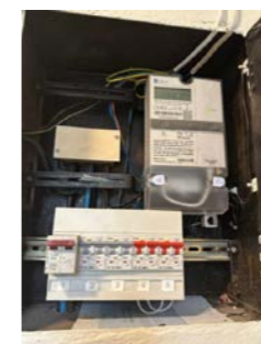
Sikringsskap med automatsikringer.
