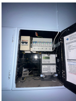
Sikringsskap plassert i felles oppgang.
