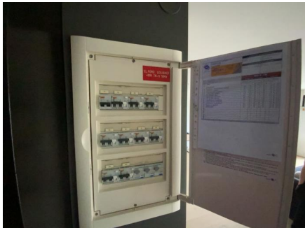
El-skap med automatsikringer.
